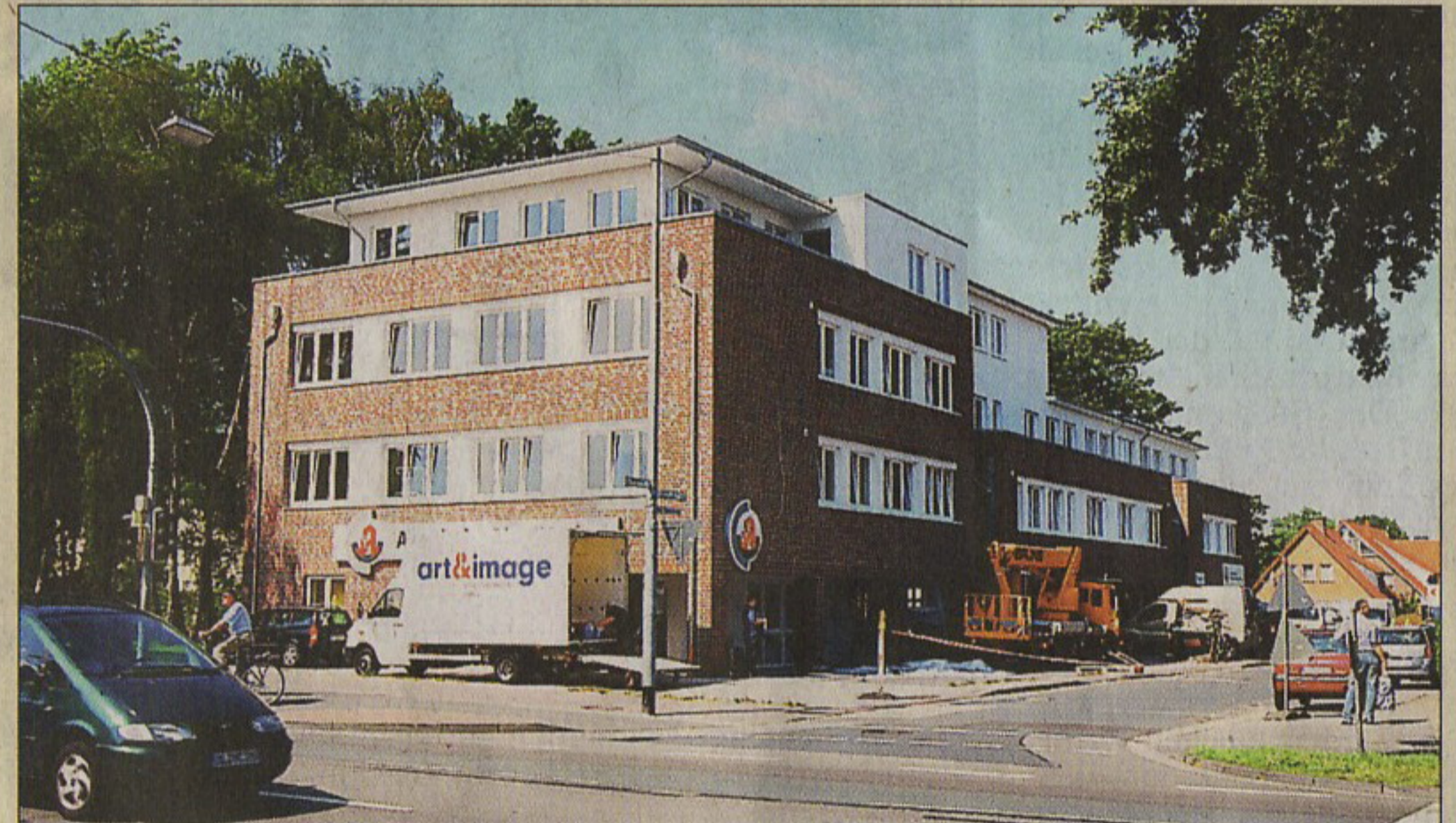
Letzte Handgriffe: Ein paar Arbeiten sind noch zu tun, die Apotheke und das Sanitätshaus sind aber bereits fertig und eröffnen an diesem Freitag.
